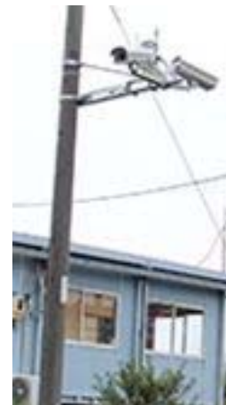
平成26年度に補助金を活用して設置された防犯カメラ(五色園)
