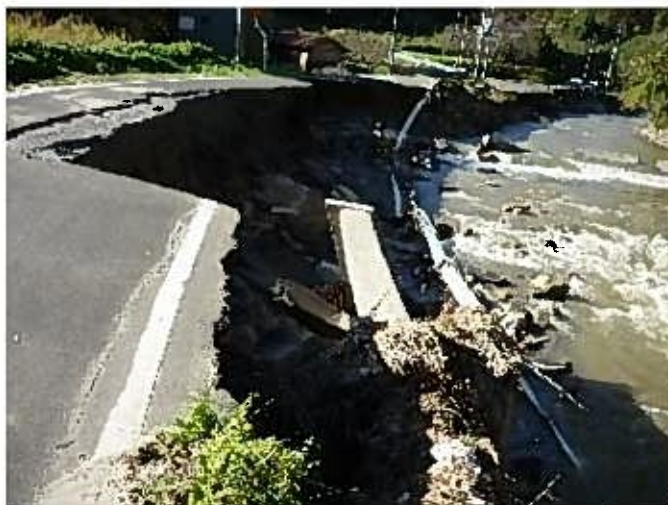
川俣町 道路・河川の被害状況
