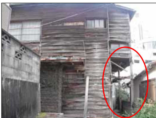
柱の数箇所に破損がある例
