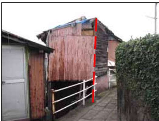
一部の柱が傾斜している例
