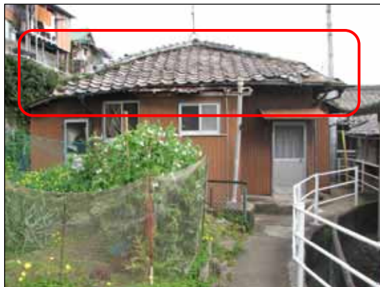
屋根に不陸がある例
